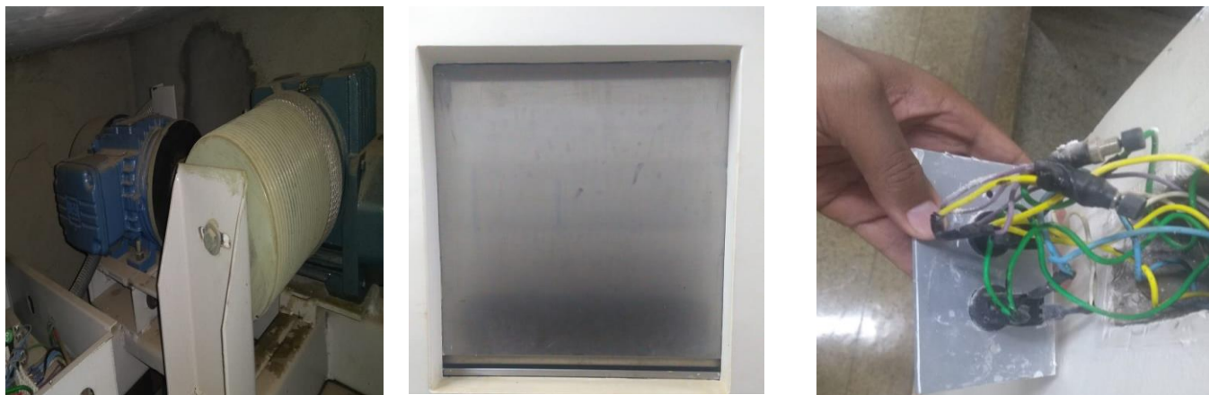
Figura 1 – Estado atual do elevador monta cargas do Fórum de Paraúna
