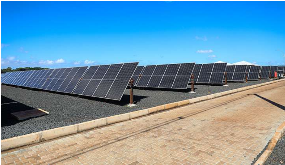
Figura 181 – Complexo Fotovoltaico do Tribunal de Justiça do Estado de Goiás
